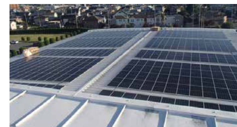
北関東工場の太陽光発電設備
