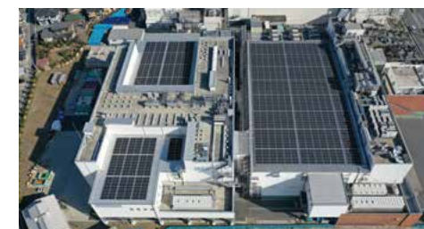
群馬工場の太陽光発電設備
