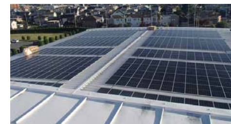
北関東工場の太陽光発電設備
